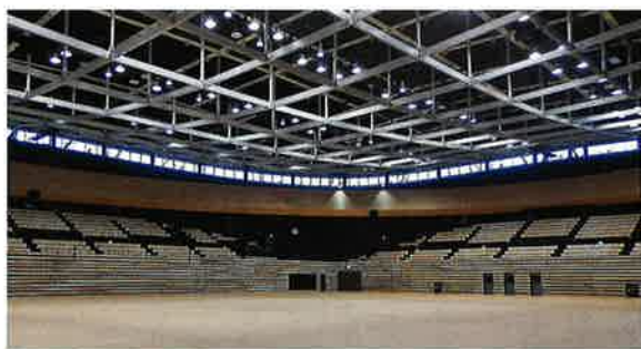
函館アリーナの内装には、準不燃処理されたハルキの内装材、「道南杉ハル壁」が使われている。
